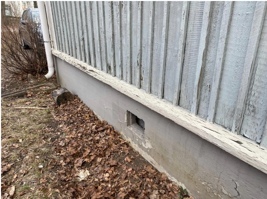
Kuva 9. Julkisivulaudoituksen alaosissa ja ulokelistassa havaittavissa yleisesti maalipintojen hilseilyä ja paikoitellen lahoa. Havaintojen mukaan rakenne ei pääse tuulettumaan.
