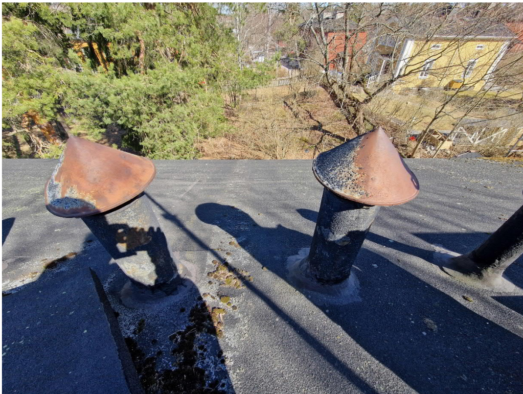
Kuva 15. Tuuletusputkien hatut ovat ruostuneet ja läpivientien tiiveys epävarma. Putkien pintamateriaalissa vahva kreosootin haju.
