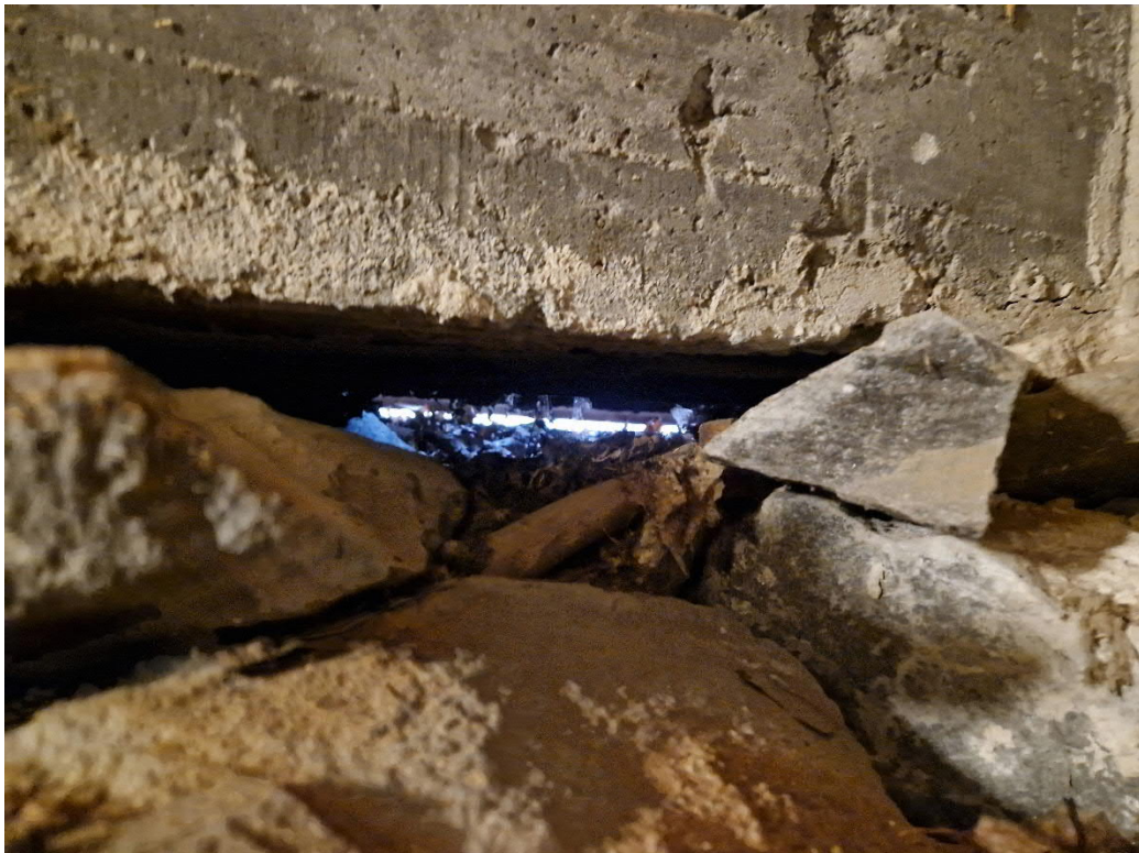
Kuva 3. Paikoitellen sokkelin alta voi valua pintavedet alapohjaan.
