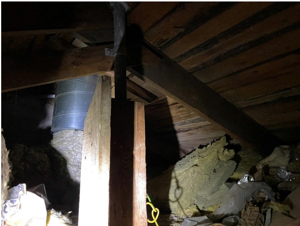
Kuva 17. Ullakkotilassa on runsaasti ylimääräisiä villalevyjä, roskia ja sinne kuulumattomia tavaroita.
