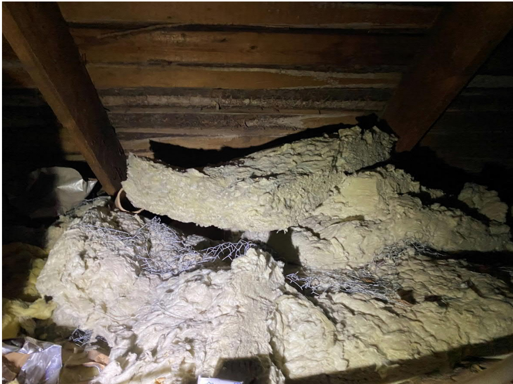
Kuva 18. Silmämääräisen arvion perusteella ullakkotilassa ei havaittu merkittäviä vuotokohtia. Pohjalaudoituksessa paikallisia tummentumia.
