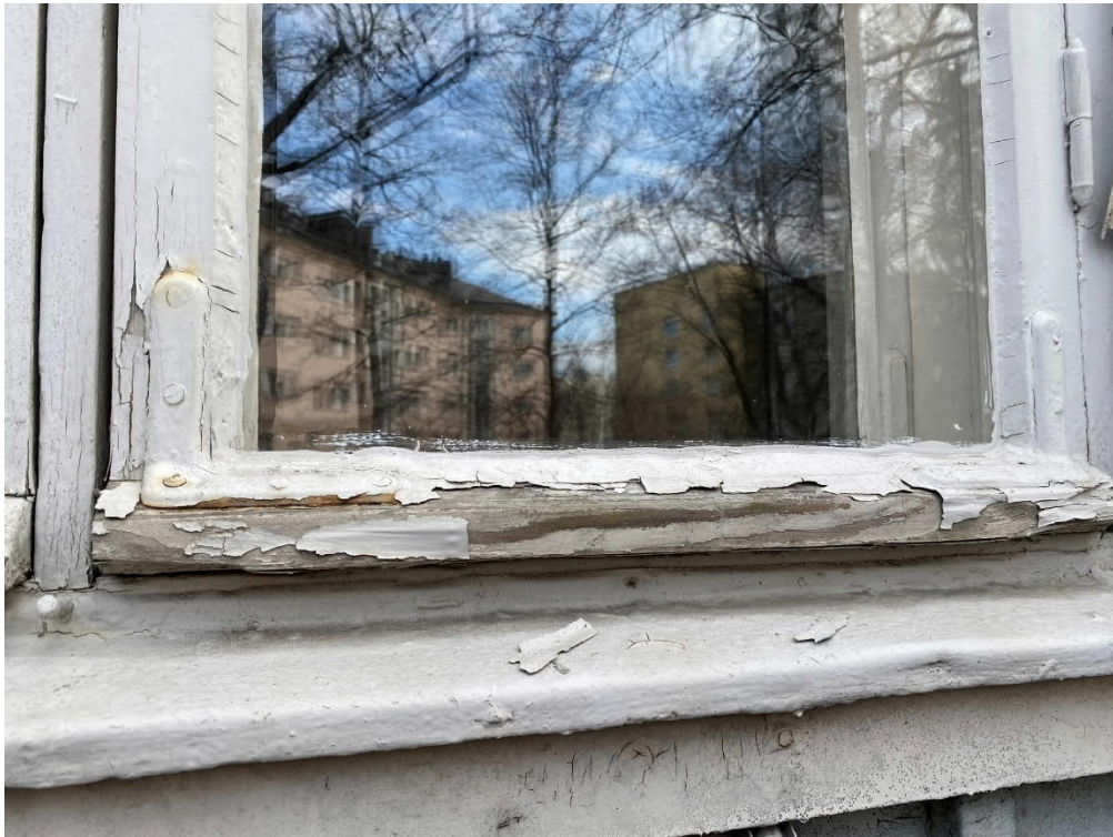
Kuva 12. Ikkunoissa havaittiin yleisesti maalipinnan hilseilyä ja lasikittausten halkeilua.
