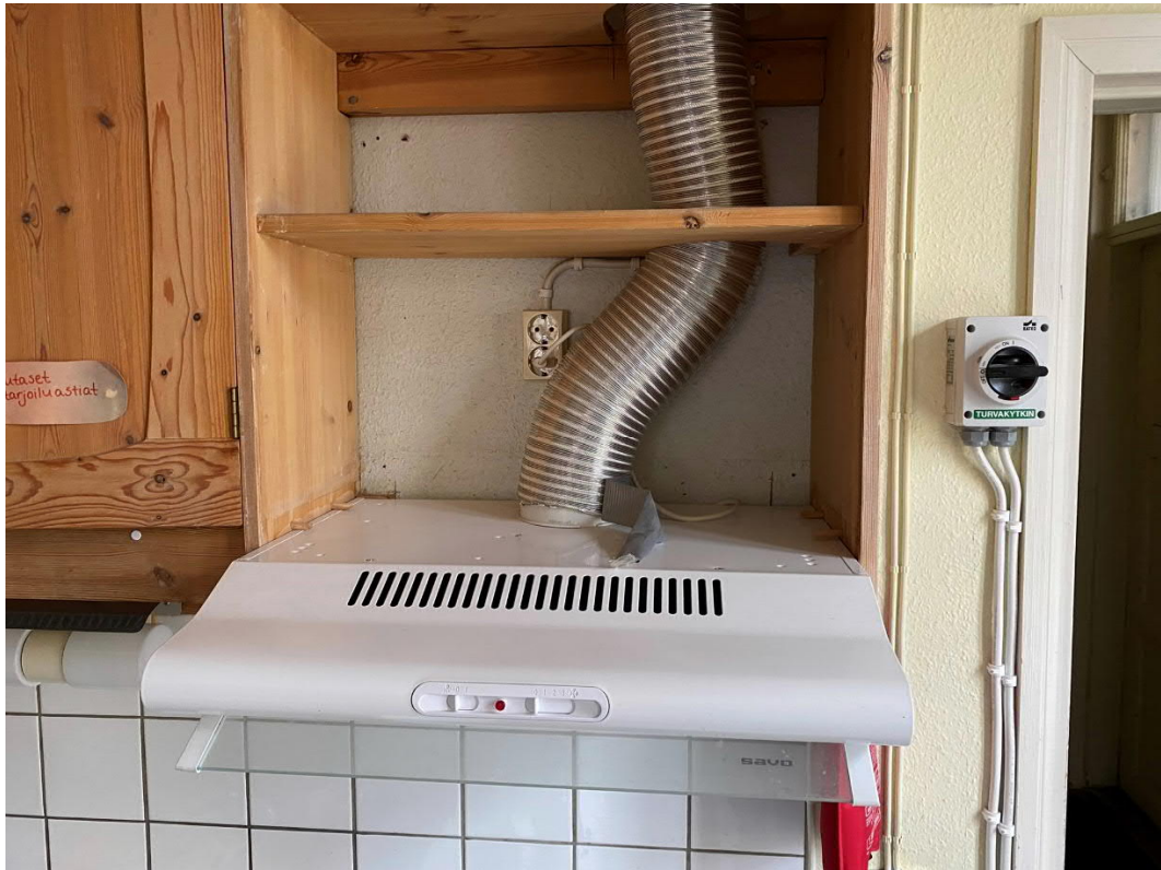
Kuva 21. 1. kerroksen liesituuletin. Tuulettimen toimivuus epävarma ja poistoimu heikko.
