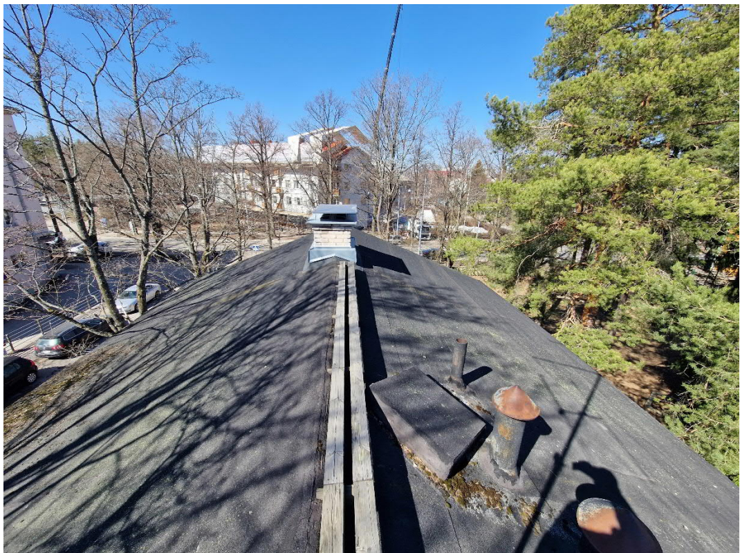
Kuva 13. Yleiskuva vesikatosta. Huopakate ja kattosillat ovat huonossa kunnossa.
