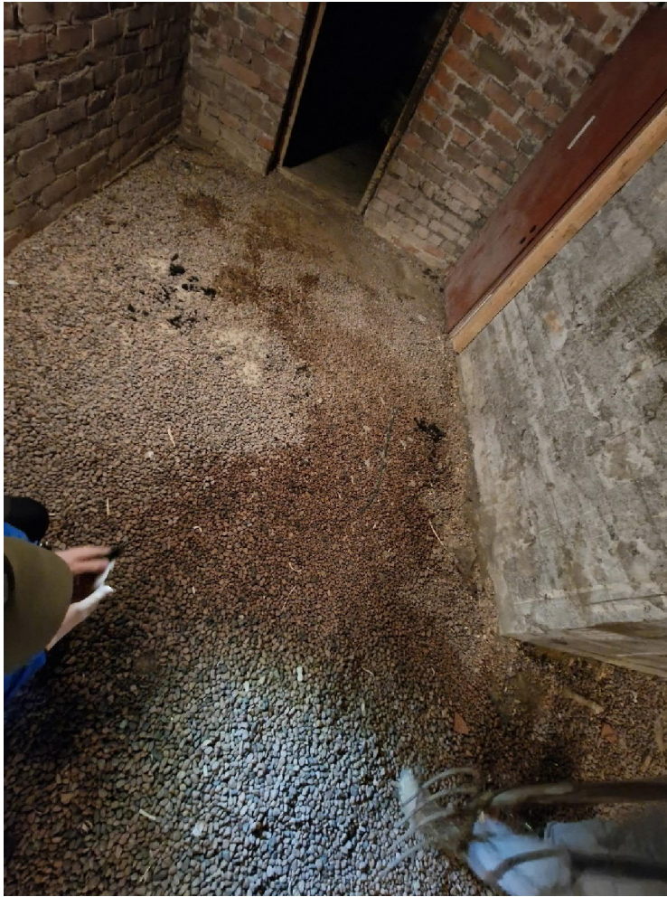
Kuva 5. Kellariin on lisätty edellisen korjauksen yhteydessä soraa. Paikoitellen sorassa havaittiin kosteampia kohtia, mistä kosteus ei ole päässyt haihtumaan tai imeytymään maaperään.
