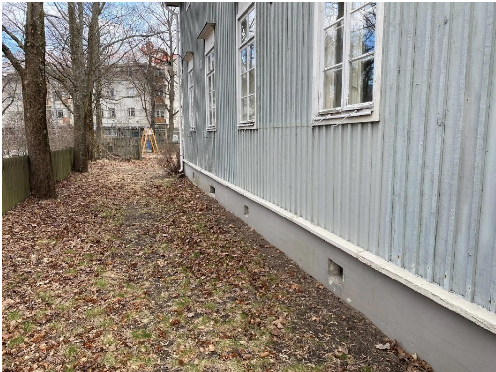
Kuva 1. Rakennuksen vierustat ovat nurmikkoa, sokkelin välittömässä läheisyydessä multaista hiekkaa. Kallistukset riittämättömät länsi ja etelä sivuilla.
