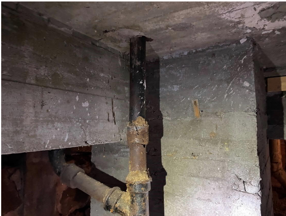
Kuva 7. Kellaritilassa on vanhoja viemäriputkia. Putkissa havaittiin reikiä, joista voi aiheutua hajuhaittaa kellaritilaan. Selkeää viemärinhajua ei havaittu. Ilmeisesti viemärit on tulpattu jostain kohtaa, joten niistä ei ole enää yhteyttä käytössä oleviin viemäriin. Viemärit voivat kuitenkin toimia ilmapuotoreitteinä käytössä oleviin tiloihin kellarin ja ylempien tilojen välillä.
