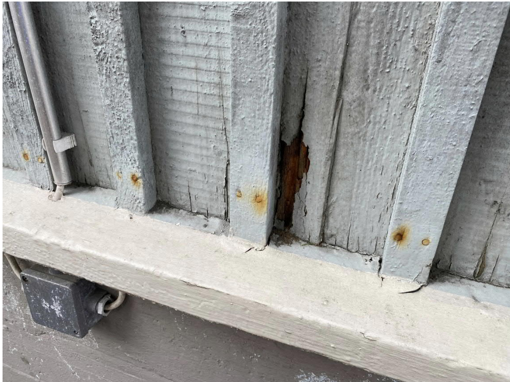
Kuva 10. Julkisivuverhoillun lahovaurioita. Sadevedet seisovat ulokelistan päällä.
